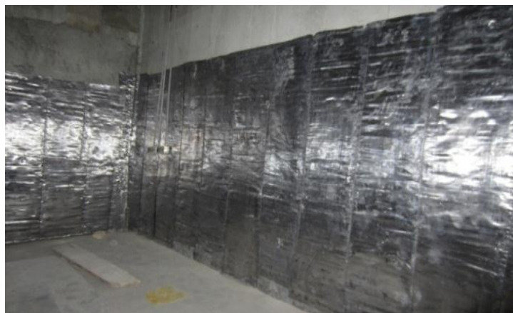
شکل ۹۳- ورق سربی روی دیوار بتونی در مراکز پرتوکاری
